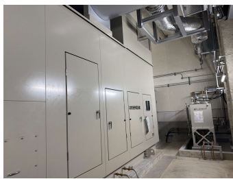
非常用自家発電機
