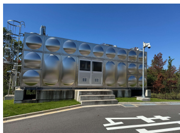
井水ろ過装置
